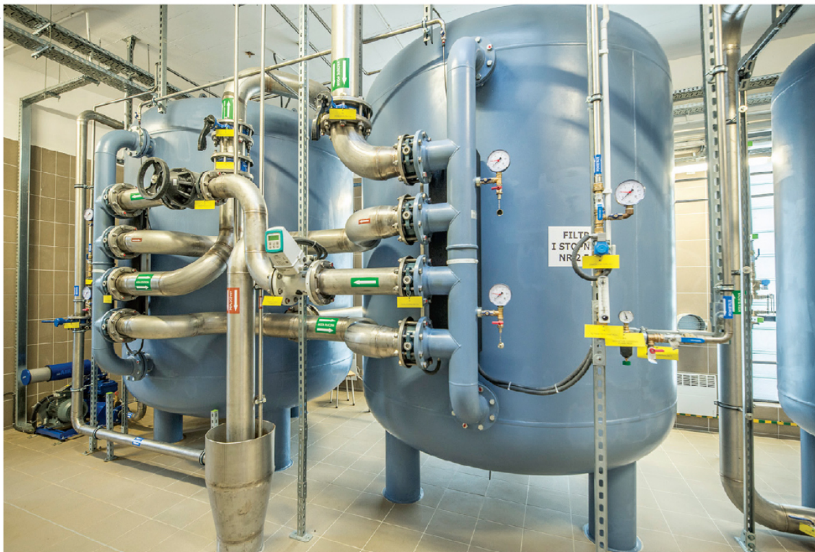
Fot. 1. Stacja Uzdatniania Wody „Partyzantów” w Chotomowie
